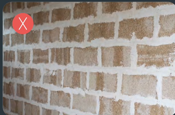
Mauvais traitement des joints
