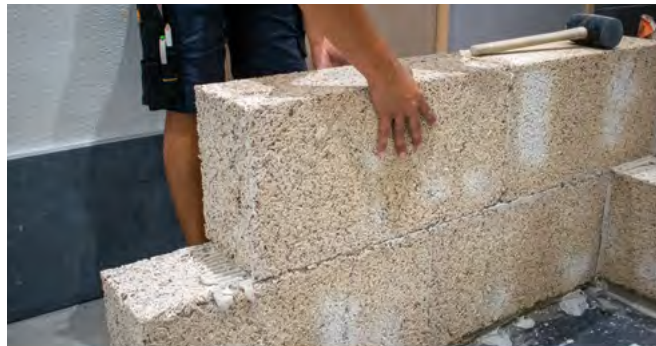
8 Posez le bloc sur la colle pour une maçonnerie en joints minces de 3 mm.
