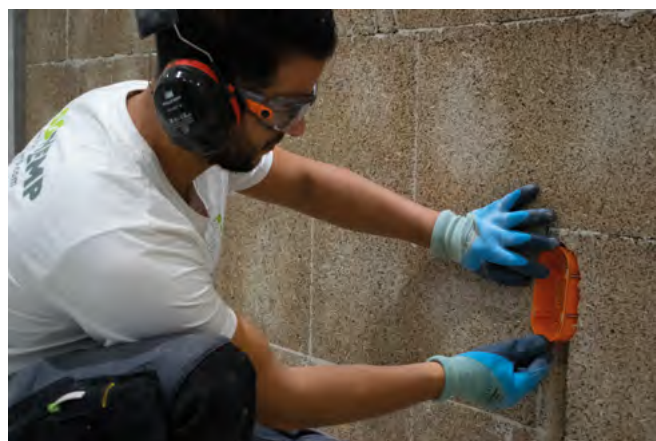
4 Récupérez les déchets de vos découpes de blocs de chanvre et broyez-les. Mélangez-les ensuite avec le liant Prokalk à raison de 50% l'un et 50% l'autre. Hydratez le mélange ainsi obtenu avec de l'eau de manière à obtenir un mélange homogène et légèrement humide. Remplissez les cavités avec le mélange.
