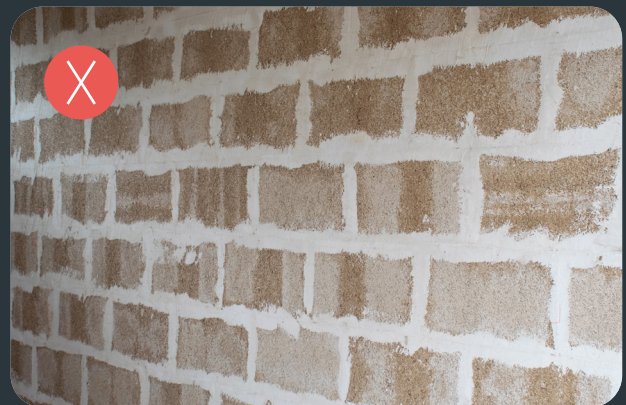
Mauvais traitement des joints
