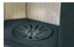
Grille en fonte, doublage des parois intérieures en chamotte claire.
